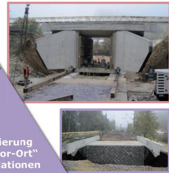
Abb. 2: (oben und unten) Verschiebung einer Vor-Ort erstellten Eisenbahnbrücke durch Pressen in die Endlage (Quelle: DB Netz AG, Tristan Mölter)
