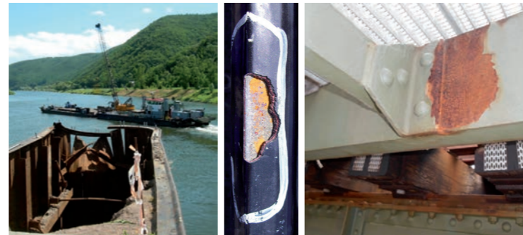
Abb. 1: Korrosion vermindert die Zuverlässigkeit der Verkehrsinfrastruktur und führt zu Folgekosten. Umweltauswirkungen durch den Einsatz von Korrosionsschutz sollen minimiert werden.
