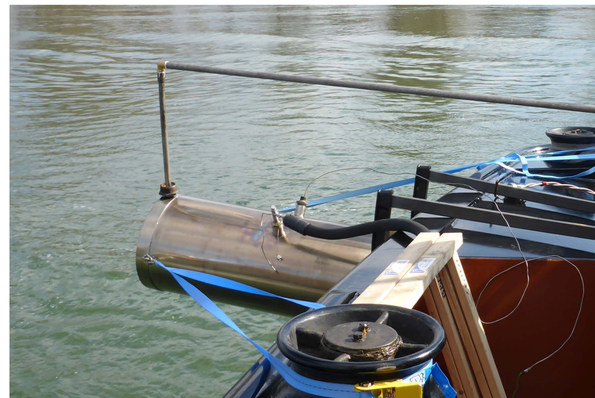
Abb. 1: Abgasendrohr mit angebrachtem Kaminaufsatz für das Einbringen der Messsonden in den Abgasstrom
