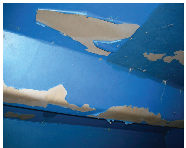
Abbildung 27: Schadensfall aus dem Wiederlagerbereich der Borkerstraßenbrücke Nr. 449 am DattelN-Hamm-Kanal mit abgängiger blauer Polyurethandekbeschichtung (Foto: Roland Baier, BAW).
