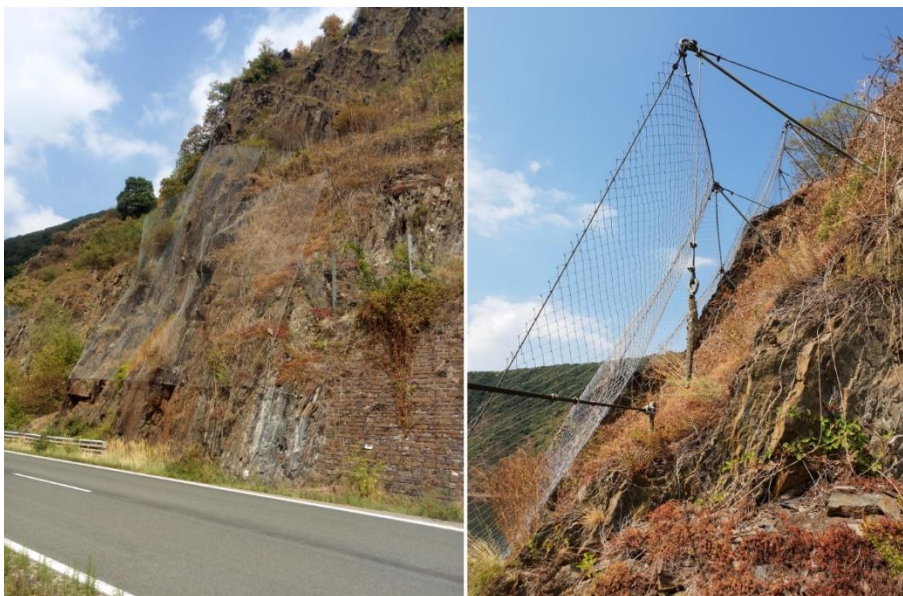
Abbildung 4-13: Sicherungsmaßnahmen der B49 an der Mosel bei Cochem; Teilweise nicht mehr funktionstüchtige Sicherungsmaßnahmen durch herausgelösten Anker des Fangzauns und mit Schutt gefüllte Fangnetze; Hinweis auf stetig stattfindende Massenbewegungen (Bilder: Lohrengel/Kirschen BASSt 2018).
