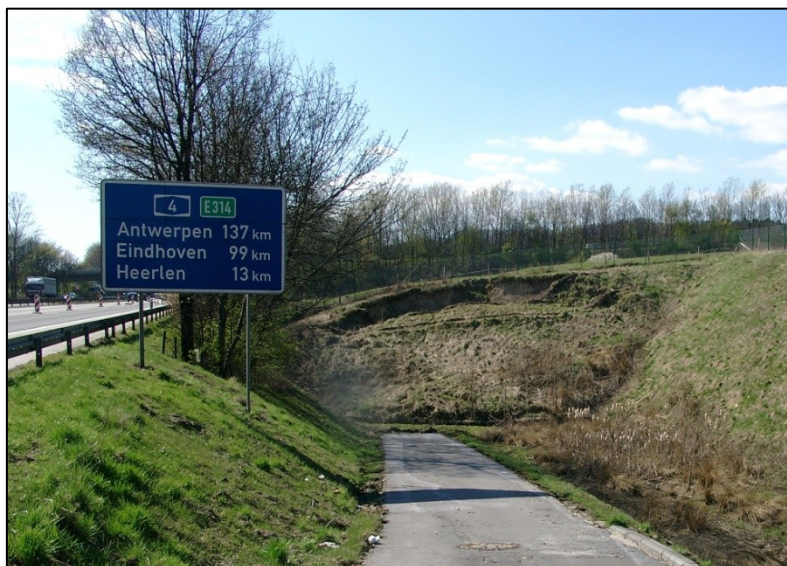
Böschungsrutschung an der BAB A 4 bei Aachen (Foto: K. Diefenthal, 2003)
